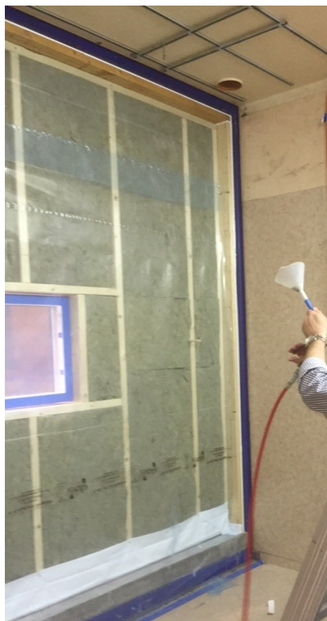
Bild 7. Konstgjort damm "sprutas" mot plastfolien
